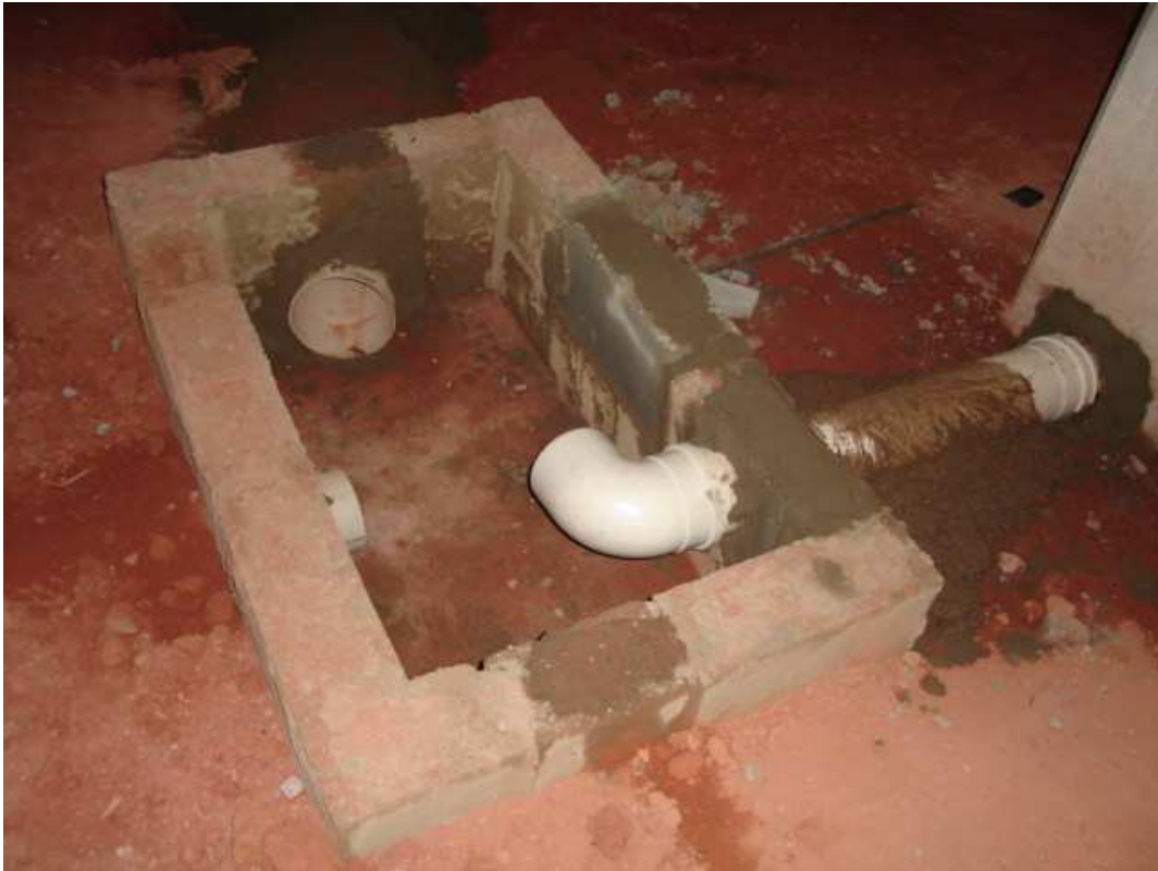
Figura 4.3.2 Caixa de inspeção e controle de águas pluviais.
