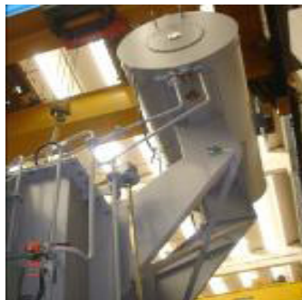
Figura 23 - Conservador de óleo (SIEMENS,2006).
