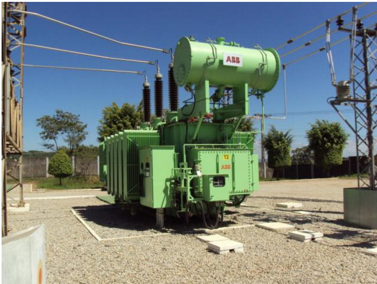
Figura 6 - Transformador de Distribuição tipo abaixador com óleo vegetal, 25 MVA 138/13,8 kV instalado na SE Pará de Minas da empresa CEMIG (TREETECH,2008).
