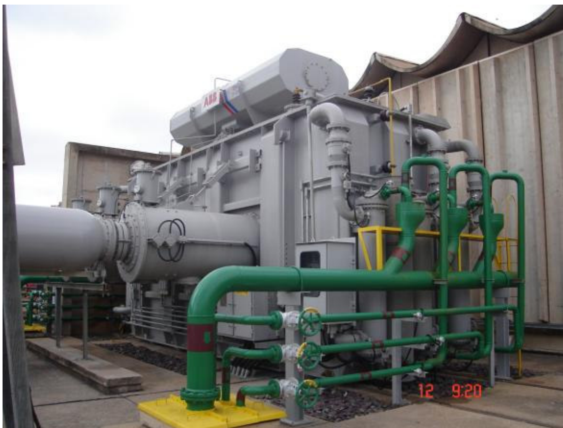
Figura 5 - Transformador tipo GSU 378 MVA 13,8/550 kV instalado na UHE de Tucuruí da empresa Eletronorte (TREETECH,2008).
