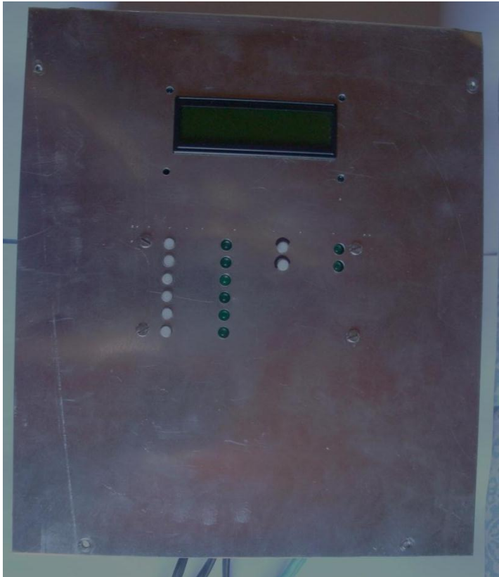
Figura 42 - Quadro de comando
