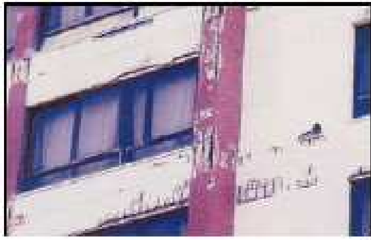
Figura 08 – Foto do desgaste do concreto
