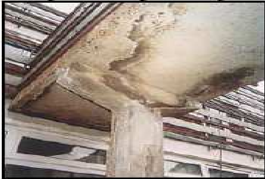
Figura 01 - Presença de cloretos no concreto
