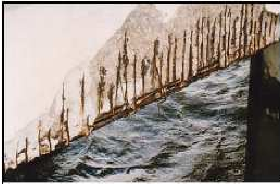
Figura 06 –Foto de uma estrutura deteriorada pela ação de ácido e sais
