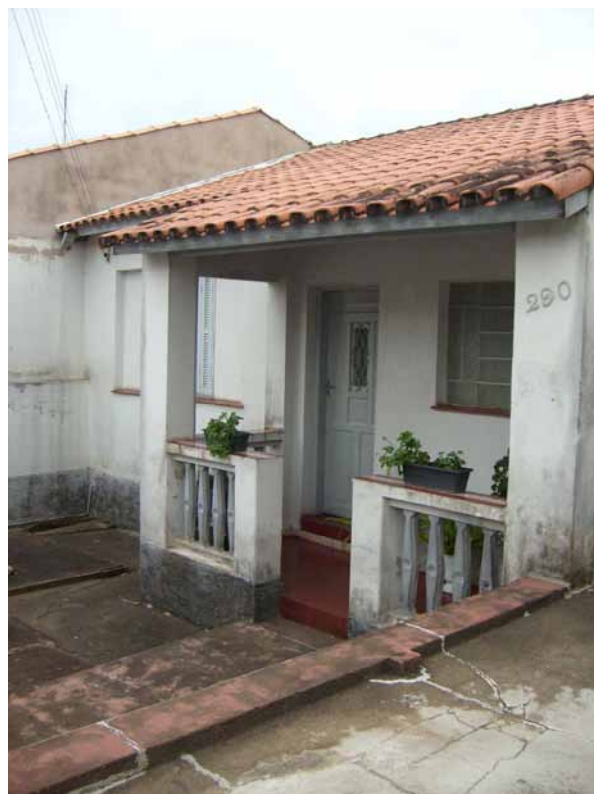
Fig.34. Residências do IAPI. Nota-se o piso de cimento queimado vermelho, a varanda “coroando” a entrada principal e a grade na porta, ideal para ventilação. Fonte: Acervo particular – 19/10/2009
